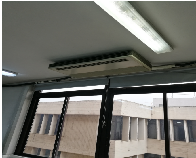
Εικ. 3 Εσωτερική μονάδα VRV Εργαστηρίων κτιρίου ΓΔ
