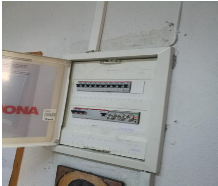
Υφιστάμενος Ηλεκτρολογικός Πίνακας σε αίθουσα διδασκαλίας
