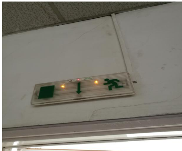
Υφιστάμενο φωτιστικό σώμα ασφαλείας
